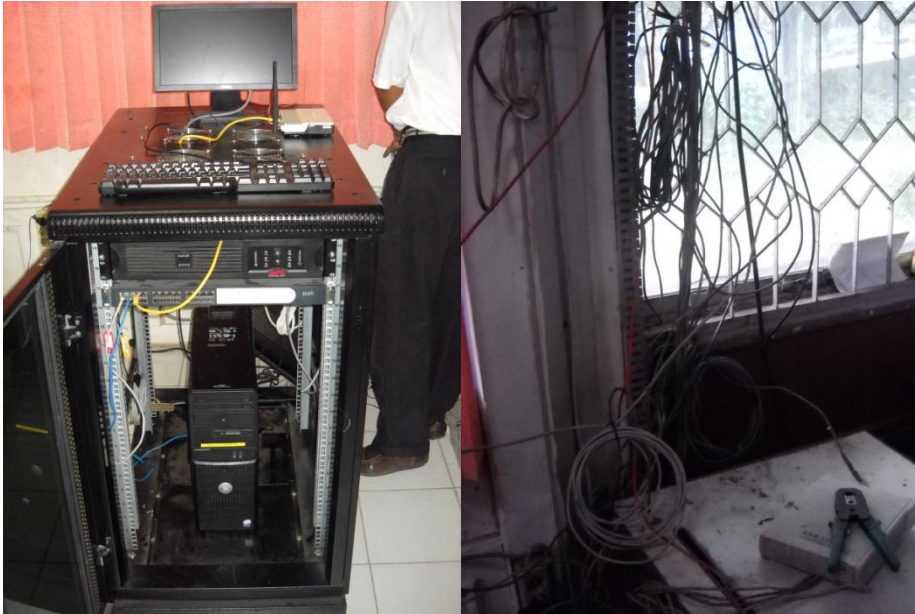
Keadaan Server dan Pengkabelan sebeelum perbaikan
