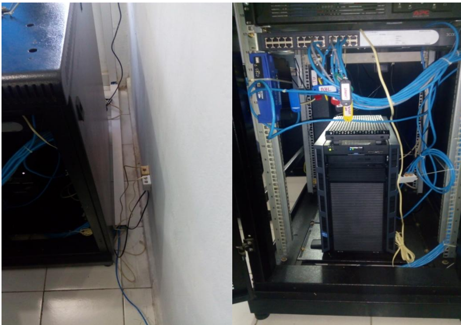
Kondisi server dan Pengkabelan setelah perbaikan
